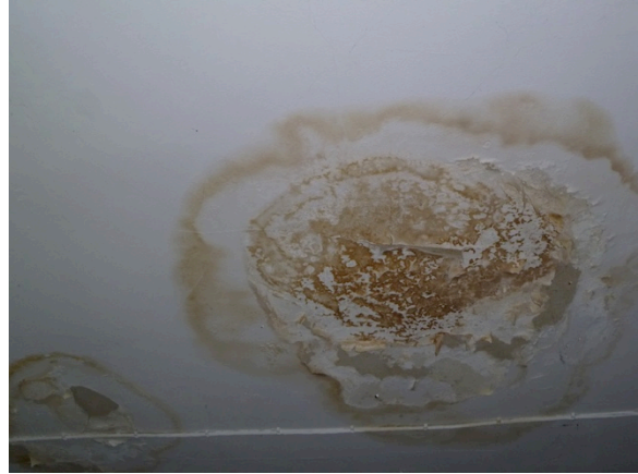
Haus 2, Raum 215, Deckenschaden
