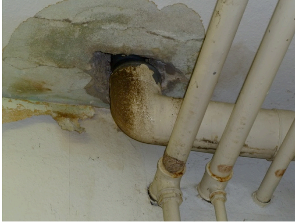
Haus 2, Raum 211, Fallrohr im Waschraum
